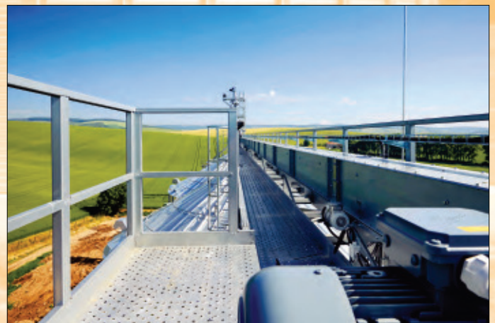
Laufsteg mit Trogkettenförderer
