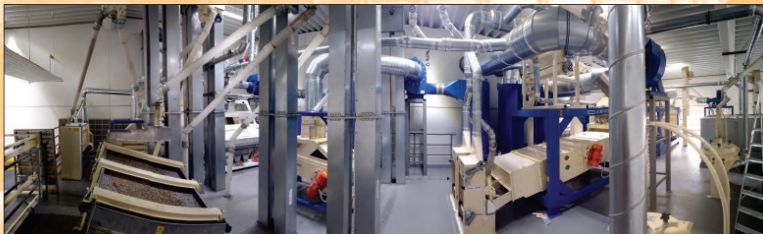
Anlage zur Aufbereitung von Sonnenblumen
