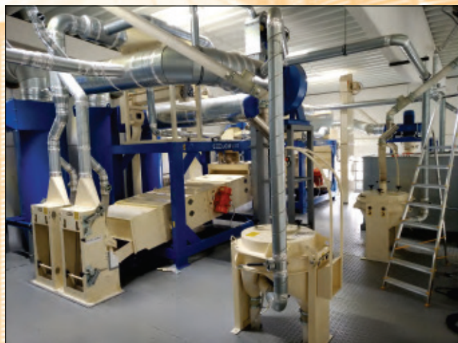
Anlage zur Aufbereitung von Sonnenblumen
